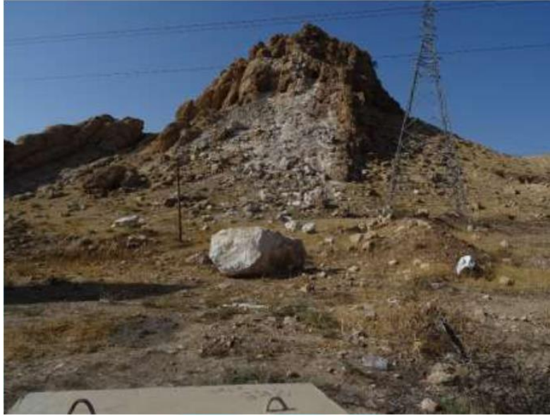
شکل ۲. ریزش سنگی روی داده در مسیر گردنه پاتاق که منجر به سقوط دکل برق فشارقوی و مسدود شدن جاده اصلی کرمانشاه - سرپل ذهاب گردید
