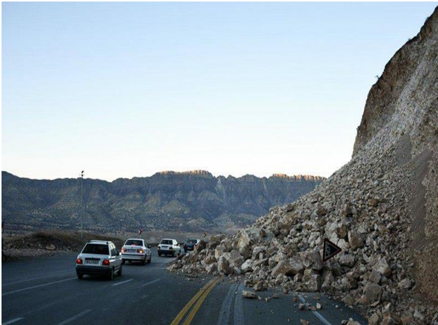
شکل ۳. وقوع ریزش سنگ در گردنه پاتاق
